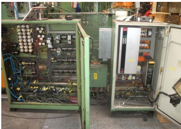
Abb. 3: Alter Schaltschrank mit Frequenzumrichter für die Aufwickler, Verlegungs-Station
