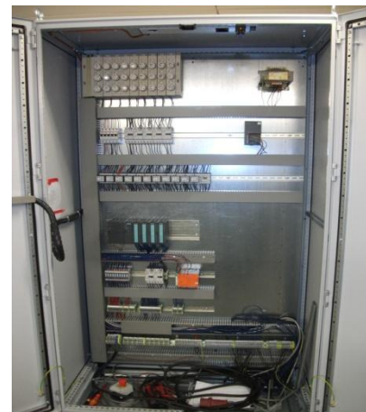
Abb.112: Befestigung wand im Schaltschrank angebracht
