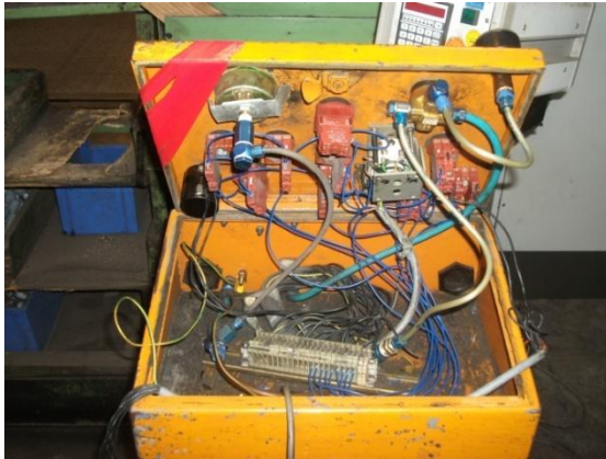
Abb,117: Bedient Pult beim umbau Messung
