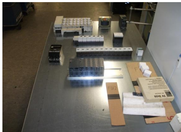
Abb. 25: Aufteilung der Hardwareelemente im Schaltschrank
